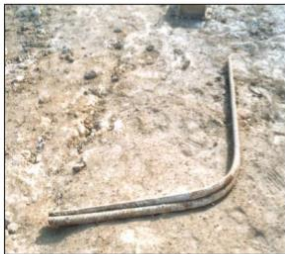
تصویر ۳-۸ آرماتور نگه دارنده قفس در دهانه چاه که بعلت عدم مقاومت کافی در مقابل وزن قفس تحت بار یاد شده بصورت فوق تغییر شکل داده است
